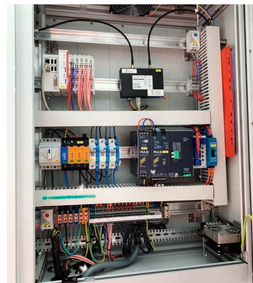
Elektroverteilung hinter Signal
