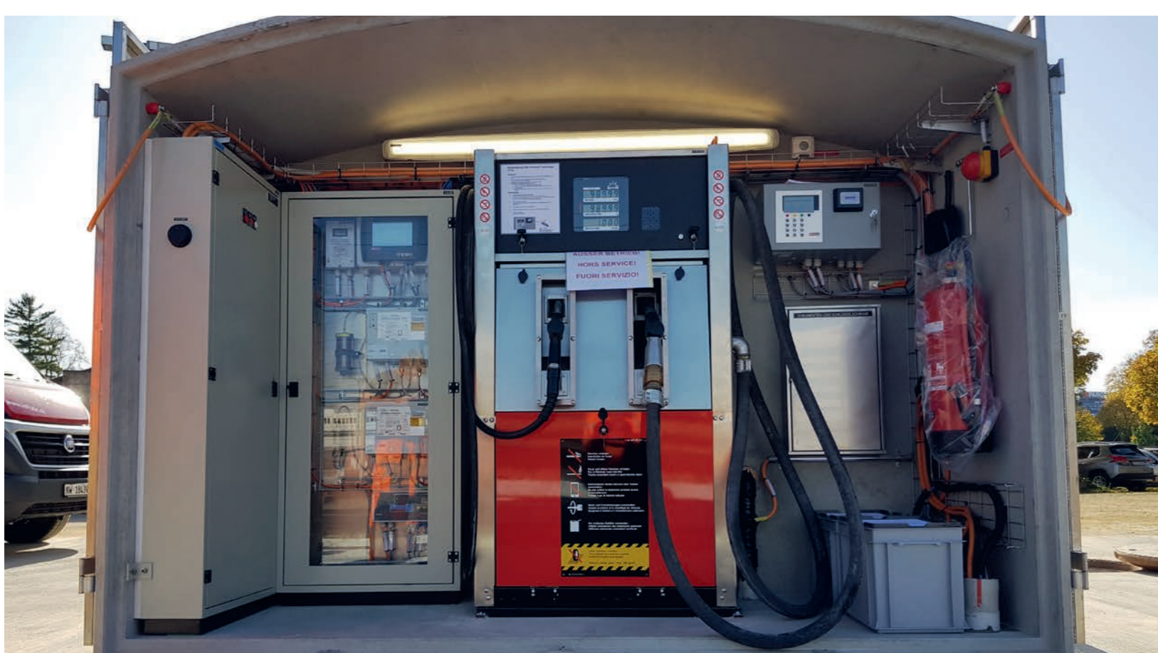
Fertig installierte Lubox-Kabine
