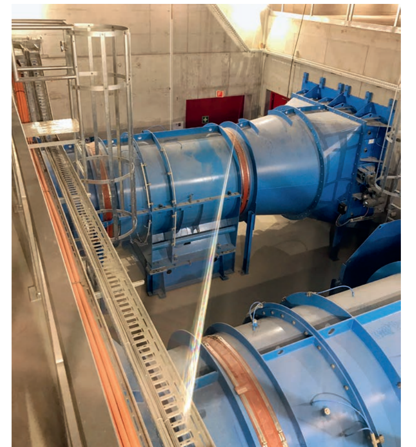
Lüftung für Tunnel
