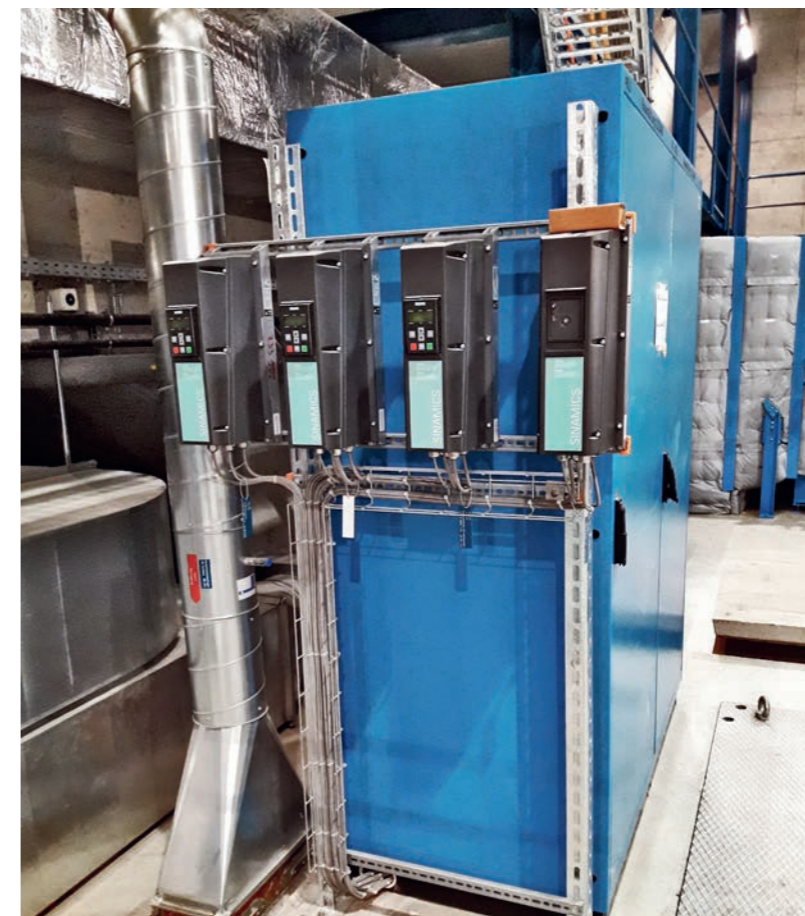
Lüftung für Zentrale
