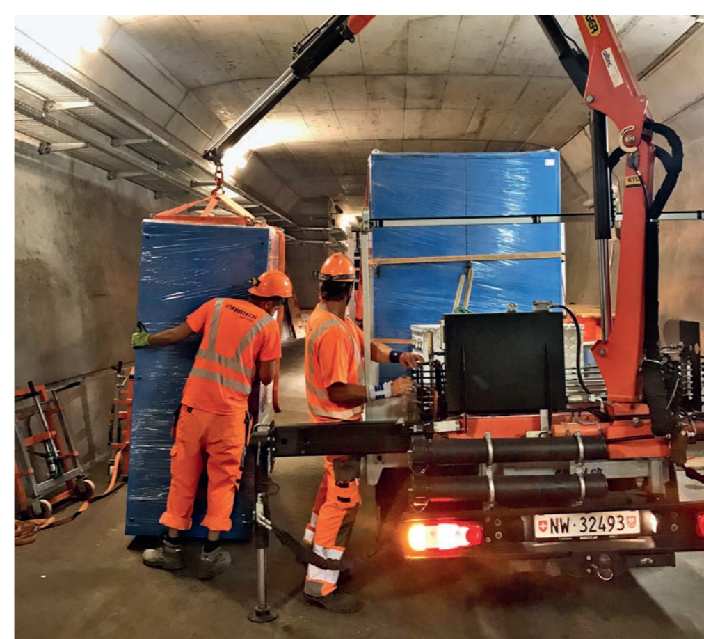
Lieferung und Montage Verteilungen
